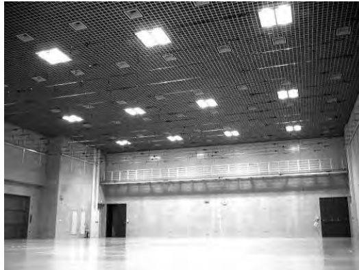
図4.2-2 天井に敷設された赤外線 LED ビーコン
