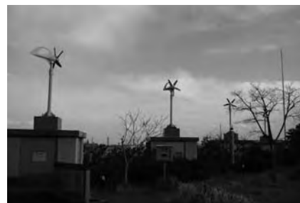
屋上に設置された風力発電設備、このほか太陽光発電や燃料電池などの設備があり、合わせて館の電力使用量の約70%に当たる電力を発電している。
