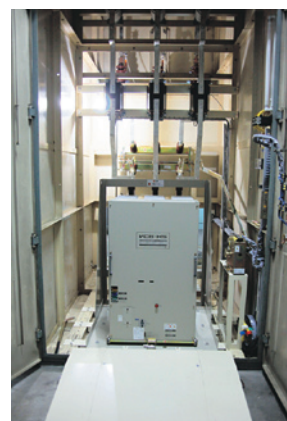
【備え付けられた新しい遮断器】
